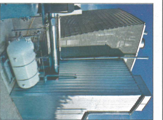
Bereits installierter Heatpipe-Reformer (Rückansicht)
